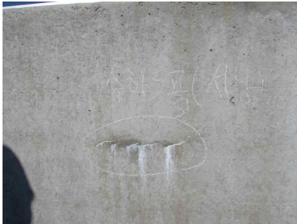
< S1 방호벽 균열 및 백태 발생 >
