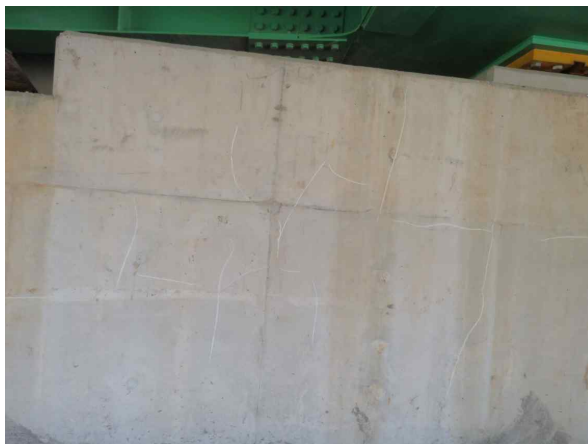
< 교대 A2 벽체 망상균열 발생 >
