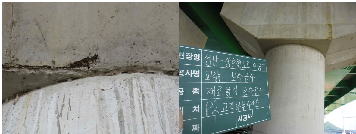
< 교각 P2 철근노출 발생 >
