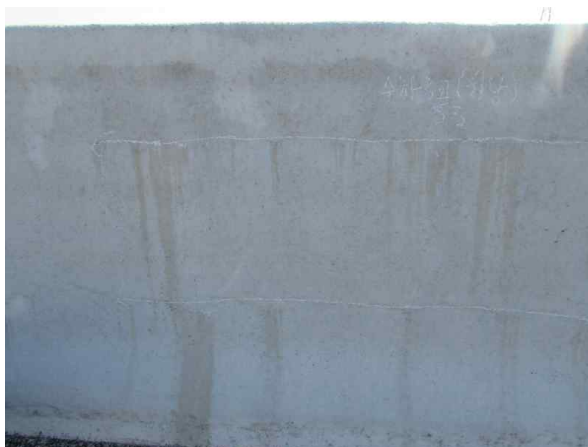
< S3 방호벽 균열 발생 >
